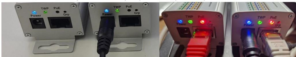
Oba převodníky jsou vzájemně propojeny
